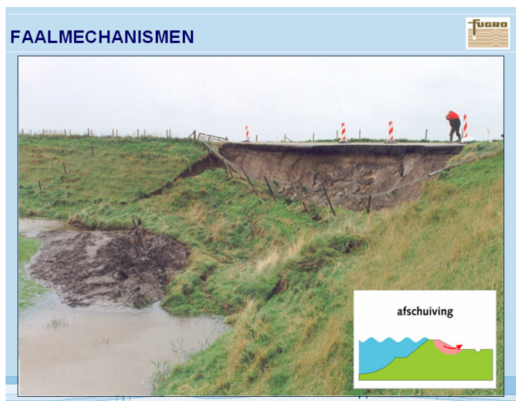
Figuur 5.2 Foto van afschuiving van een talud.
